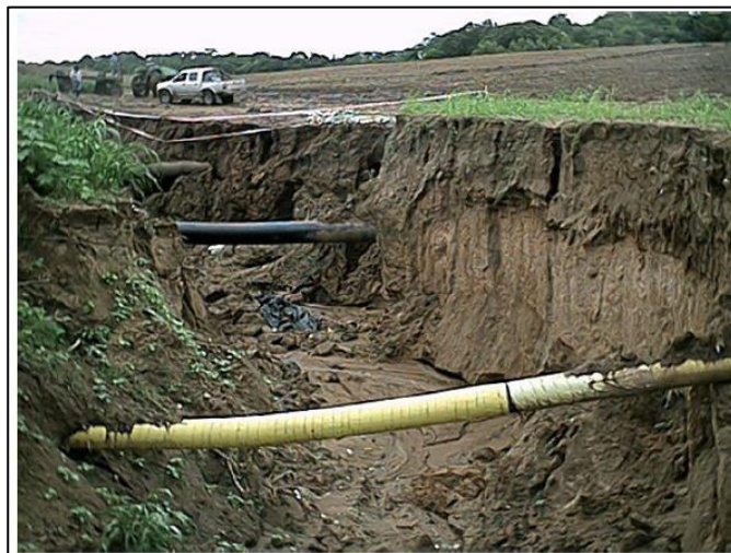
Figura 4.8 Tubería expuesta y doblada debido a inundaciones. Fuente: Enbridge Incorporated. Hazardous Liquid Pipeline Rupture and Release. Julio, 2012
