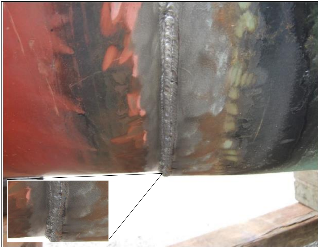
Figura 4.5 Defecto de construcción en la soldadura de la tubería. Fuente: Tomada de Pictures of Pipeline Material and Construction Quality Issues, PHMSA. Junio 15, 2012.
