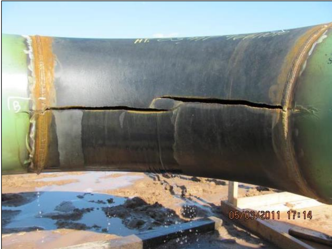
Figura 4.4 Defecto de fábrica de la tubería durante pruebas de presión. Fuente: Tomada de Seminario ROSEN SEMINAR México octubre 2019 Gerencia del Riesgo impartido por P. Guillen.
