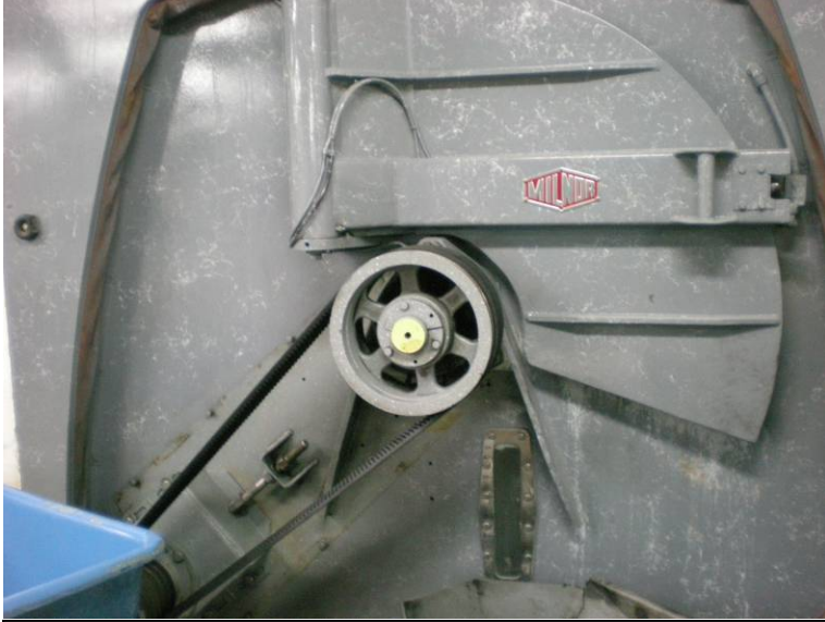
Lavadora Industrial Marca Milnor (Propiedad del Hospital Juárez de México)
